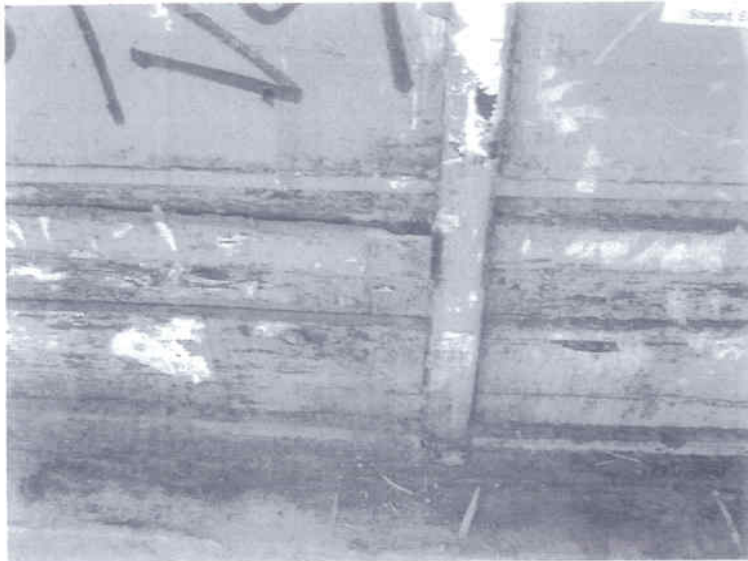
2.sz.kép : az alsó betét a takarólécekkal korhadt, sérült
